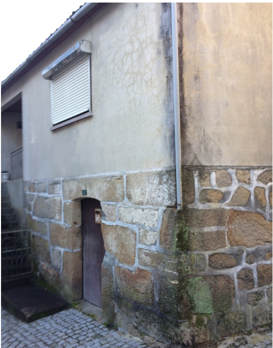
43 | Manchas, bolores e condensações
