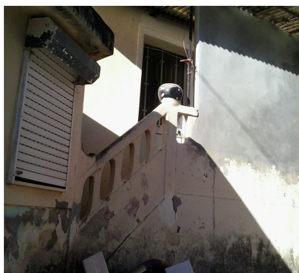
44 | Desagregação de reboco
