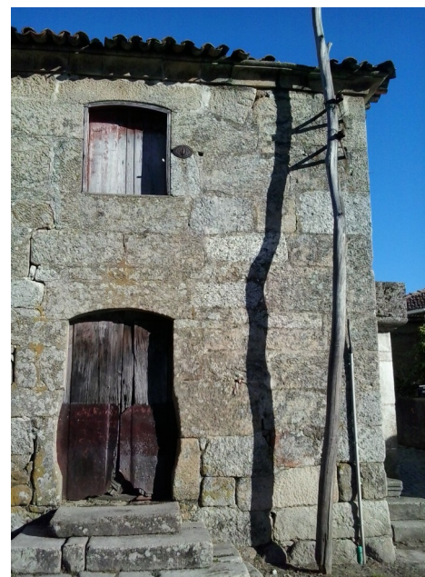
38 | Cobertura com quebras
