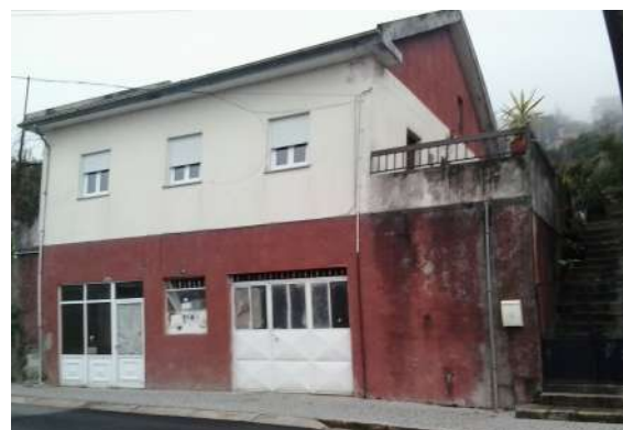
68 | Manchas, bolores e condensações
