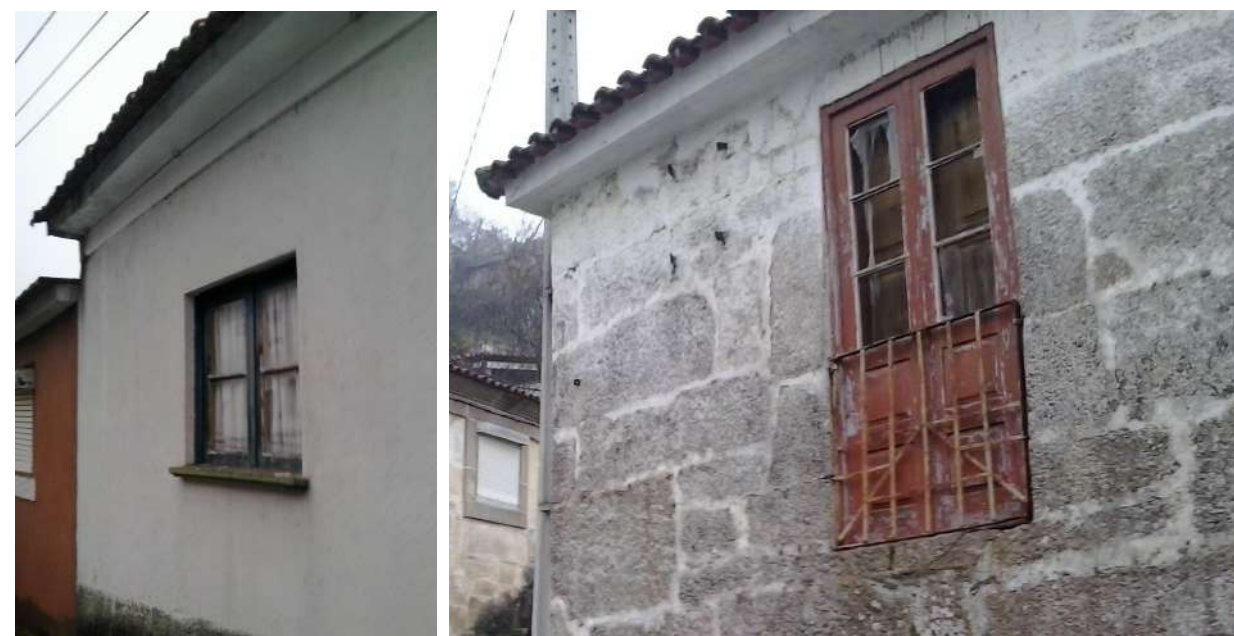
73 | 74 | Caixilharias em degradação
