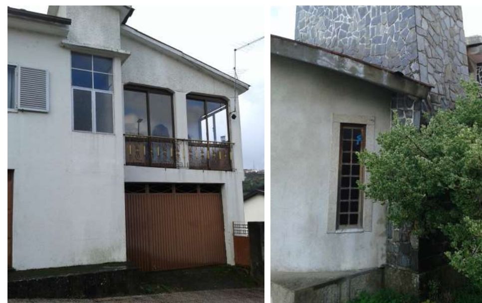
87 | 88 | Caixilharias em degradação
