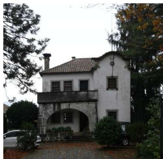
82 | Manchas, bolores e condensações
