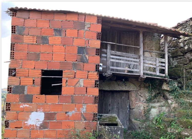
Figura 31 - Fachada com elementos dissonantes
