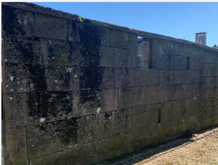
Figura 32 - Fachada com manchas/condensações e bolores
