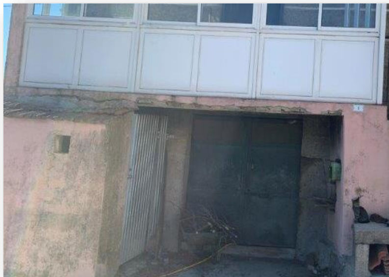
Figura 34 - Fachada com fendilhação / fissuração
