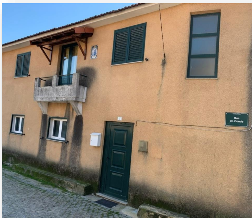
Figura 30 - Fachada com manchas/condensações e bolores
