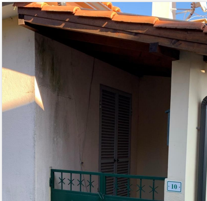
Figura 32 - Fachada com fendilhação / fissuração
