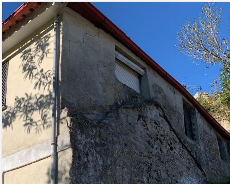
Figura 36 - Fachada com fendilhação / fissuração
