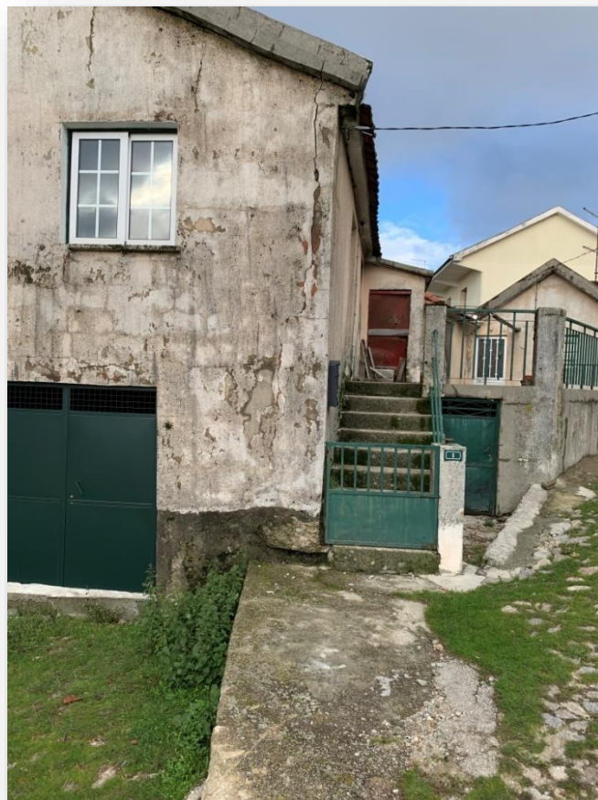
Figura 31 - Fachada com fendilhação / fissuração
