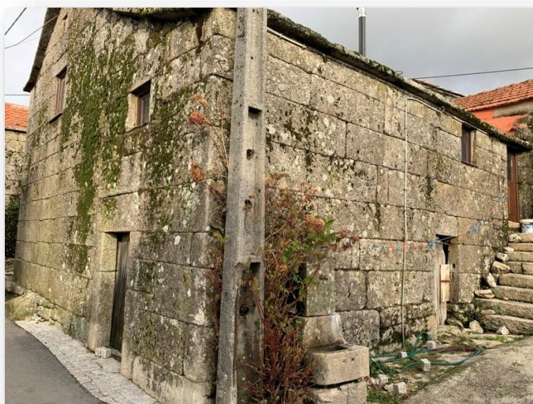
Figura 29 - Fachada com manchas/condensações e bolores
