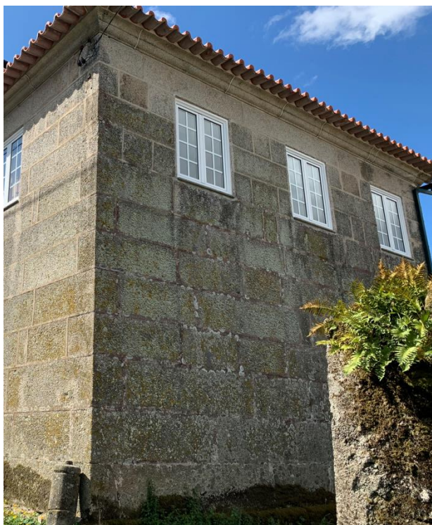
Figura 35 - Fachada com manchas/condensações e bolores
