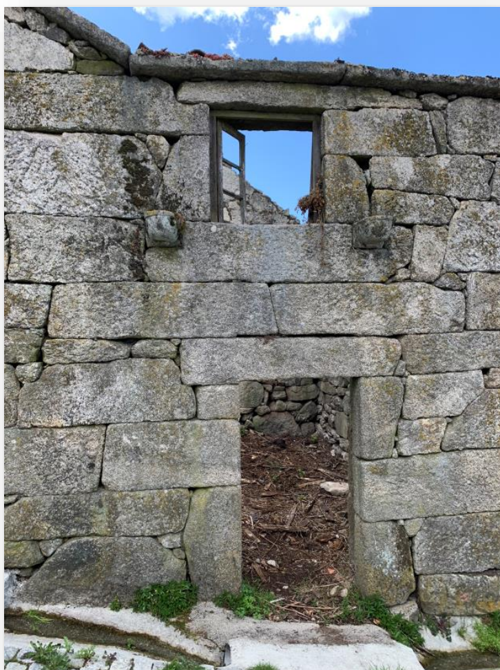
Figura 27 - Cobertura com estrutura colapsada
