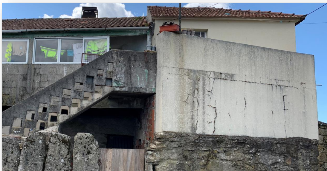
Figura 31 - Fachada com fendilhação / fissuração
